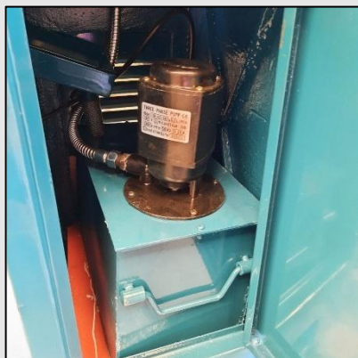
Equipo de refrigeración
