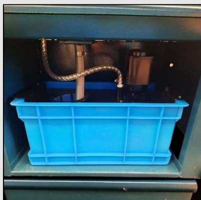
Equipo de refrigeración
